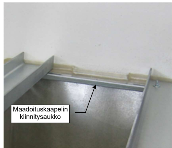
Kuva 10 Muuntajan asennuskiskojen maadoitus
