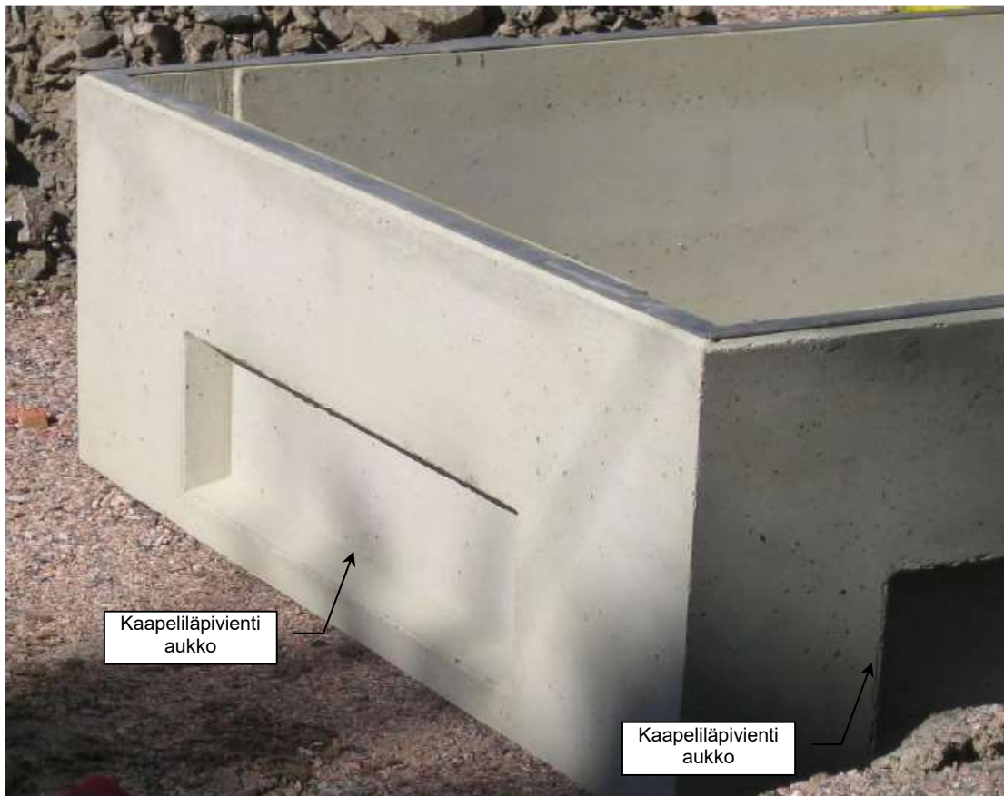
Kuva 7 Kaapelikellari ja tiivistemateriaali
